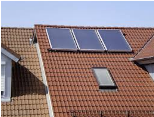
Bild 39: Beispiel thermische Solaranlage auf Hausdach
